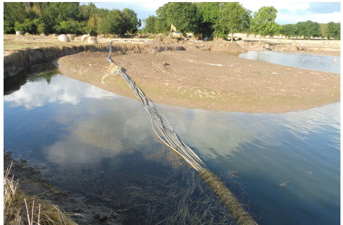
Beschädigung kritischer Infrastruktur Strom: Freigespülte Leitungstrasse; unterwasserseitig, Blick in Fließrichtung; HRB Horchheim, Erftverband (Quelle: Lothar Kirschbauer, 2021).
