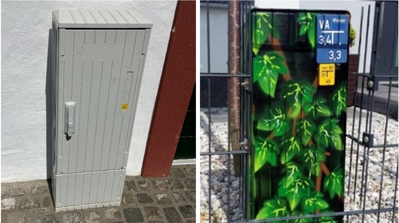
Abbildung 17: Hausanschlusssäule (links: an Hauswand, rechts: anderer Fixpunkt) 78
