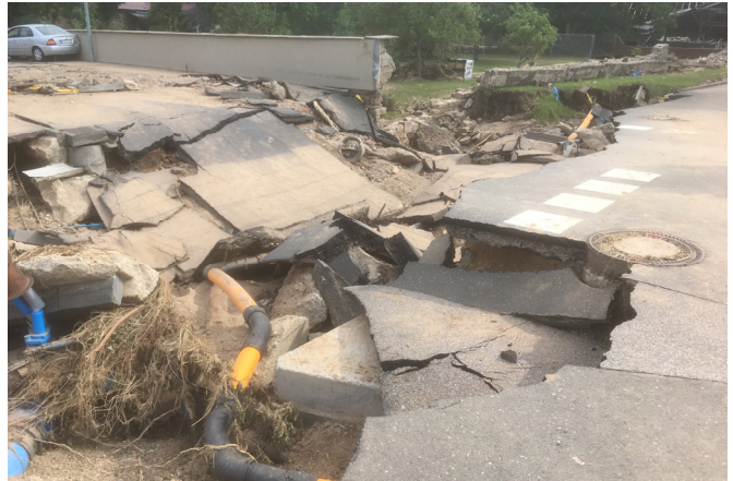
Beschädigung kritischer Infrastrukturen Leitungen und Straße: Starke Beschädigung einer Straße und Leitungen – beeinflusste Komponente Straße wirkt sich auf abhängige Komponente Leitungen aus, da diese durch den Zusammenbruch beschädigt wurden. Auswirkungen durch den Infrastrukturausfall für die Bevölkerung (Quelle: Westnetz GmbH, 2021).
