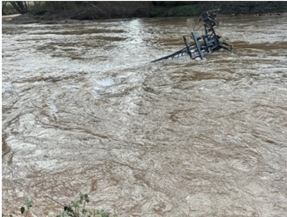
Beschädigung kritischer Infrastruktur Strom: Umgekippter Strommast – beeinflusste Komponente, die über den Infrastrukturausfall zu Auswirkungen für die Bevölkerung führt (Quelle: Westnetz GmbH, 2021).
